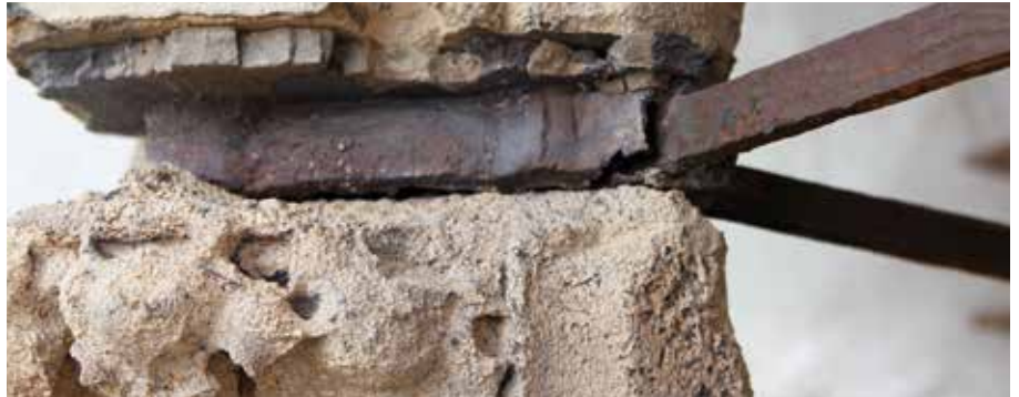
links oben – Rostschutzarbeiten, rechts oben – völlig durchgerostete Eisenhalterung, unten – Steinsprengungen aufgrund der thermischen Dehnungen im Eisen
