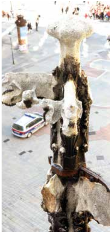
Verwitterte Kreuzrossette von Sinterkrusten überzogen, Teile schon abgesprengt
