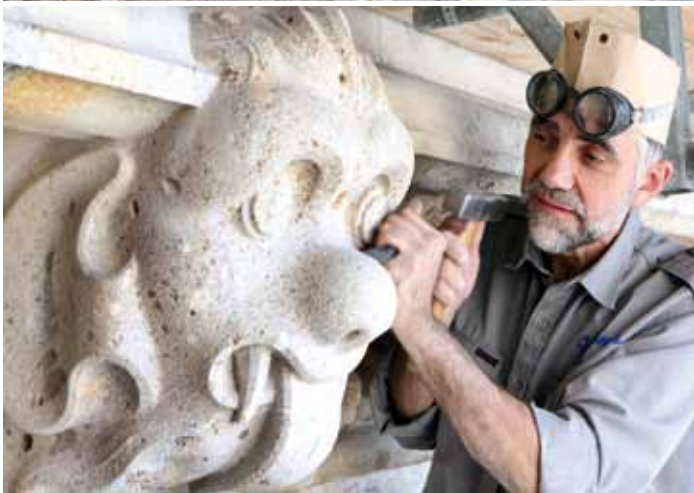
oben: ein bis zur Unkenntlichkeit verwitterter Maskaron am Südturm mitte: ein „Platzhalter“ aus Holz für den neuangefertigten Maskaron unten: Anpassungsarbeiten der Maskaron-Kopie durch einen Bildhauer der Dombauhütte
