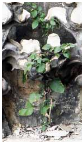
Algen, Moose, Flechten, aber auch kleine Bäumchen sprengen mit ihren Wurzeln die Steinspalten.
