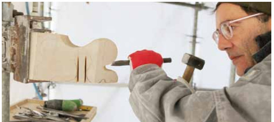
Steinmetzarbeiten am Gerüst – eine Krabbe wird direkt „an Ort und Stelle“ aus dem Stein gehauen.
