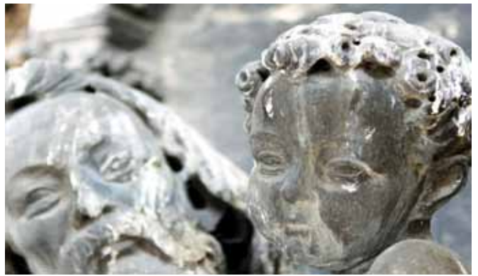
Der fein ausgearbeitete Figurenschmuck am Südturm ist von Taubenkot verschmutzt.
